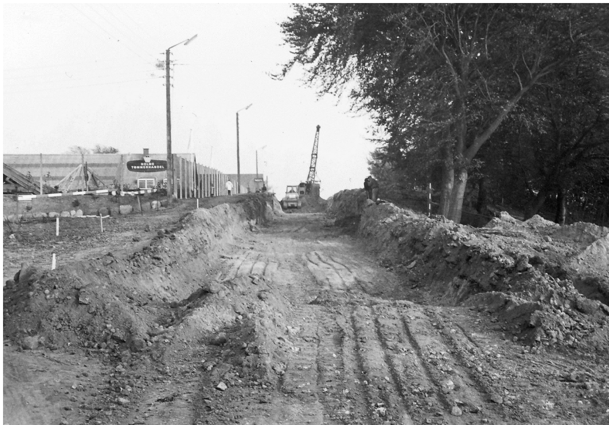
Fig. 3. Til venstre ses Holme Tømmerhandels store lagerbygning på fotografi taget 14. oktober 1964. Til højre er man i gang med at omlægge Hjulbjergvej. I forgrunden til venstre hjørnet ved Kvædevej. Omkring tømmerhandlen er der et højt metalhegn på betonstolper. Hegnet er nu fjernet ud mod Hjulbjergvej og erstattet af en støjskærmende jordvold, men står stadig ud mod Kvædevej som i tømmerhandlens tid. Set mod øst. Billedet tilhører Højbjerg-Holme Lokalhistoriske Arkiv www.arkiv.dk B1973.
